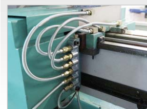
► Rozvod centrálního mazání
