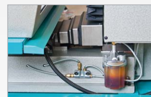
Centrální rozvod mazání
